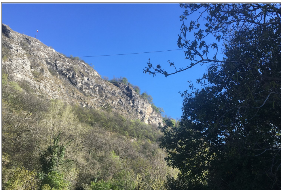
Figura 25 – Vista della medesima area rappresentata nella figura 19 dalla quale si sarebbero staccati i massi secondo la segnalazione pervenuta al Comune di Caravate nell'estate 2017, ripresa dal piazzale antistante la Chiesa parrocchiale (foto del giorno 05.04.2019).
