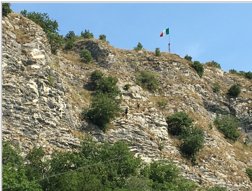
Figura 27 – Vista della parete rocciosa di Sasso Poiano durante le operazioni di disaggio (foto del giorno 03.07.2019).
