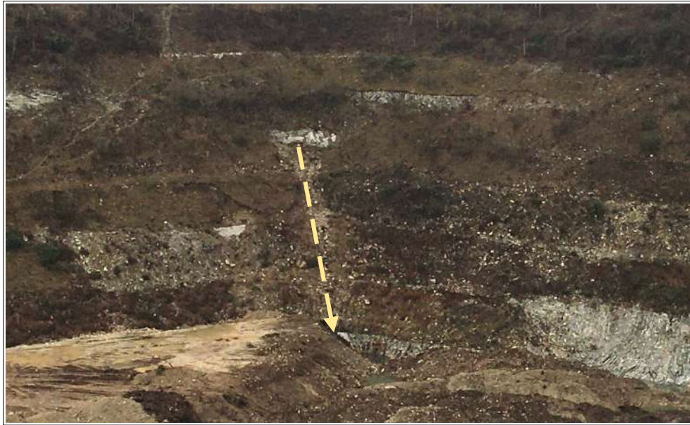
Figura 18 - Il solco d'erosione (freccia di colore giallo) da sistemare con tecniche di ingegneria naturalistica
