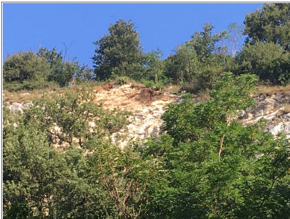
Figura 16 – Vista dell'area della figura 14 dalla quale si sarebbero staccati i massi secondo la segnalazione pervenuta da un cittadino al Comune di Caravate, vista dal piazzale della Chiesa Parrocchiale (foto del 01.09.2017).
