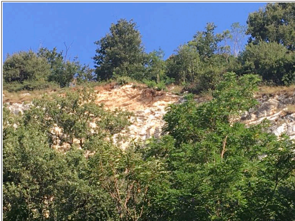
Figura 15 – Vista dell'area della figura 13 dalla quale si sarebbero staccati i massi secondo la segnalazione pervenuta da un cittadino al Comune di Caravate, vista dal piazzale della Chiesa Parrocchiale (foto del 01/09/2017).
