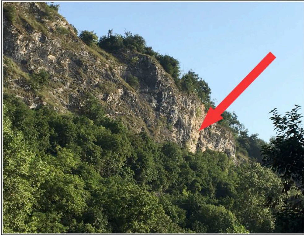
Figura 18 – Area da cui si sarebbero staccati i massi secondo la segnalazione pervenuta, vista dal piazzale della Chiesa Parrocchiale (foto del 04.08.2017).
